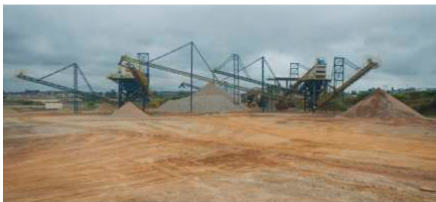
Usina de Reciclagem de Entulho e Concreto
